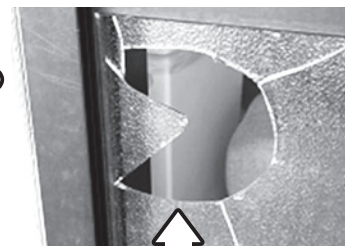
クレセント錠部分が破壊された状況
