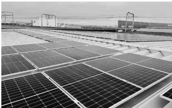
設置した太陽光パネル
